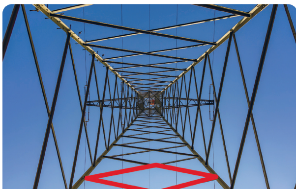
Poste de energia.
